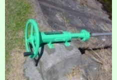
ゲート、バルブの更新
