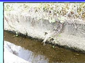
既設水路の劣化状況
