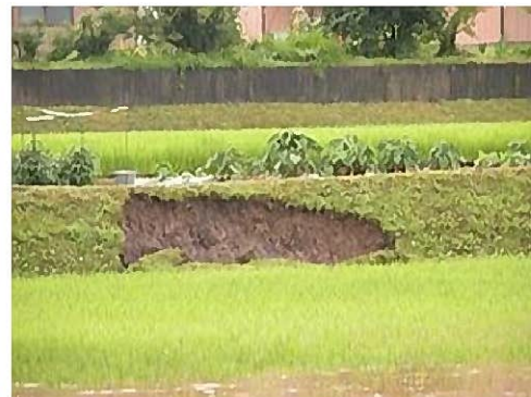
法面の崩壊状況
