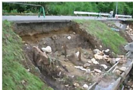
道路法面の崩壊状況
